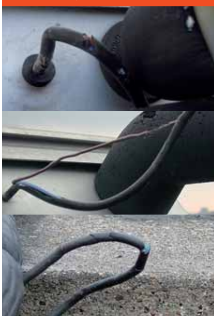
Rys. D.2.1-1 niechronione przewody czujnika kolektora
